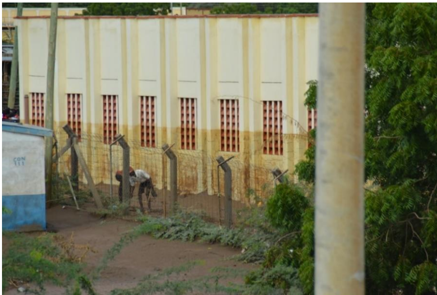
Am Gebäude ist zu sehen, wie hoch das Wasser in der Stadt angestiegen war.
