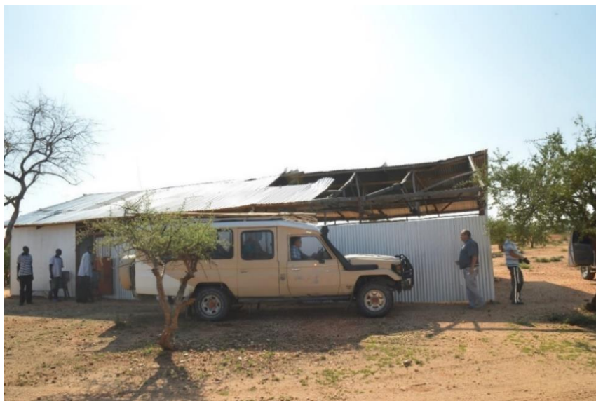
Das Dach wurde von einem Wirbelsturm aufgerissen.
