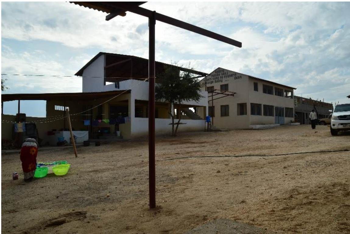
Zwischen den zwei Gebäuden fehlt die Dachkonstruktion. Ganz rechts steht der Rohbau ohne Dach.
