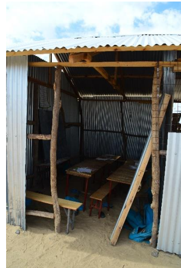
Bei diesem Klassenraum fehlt die Tür.
