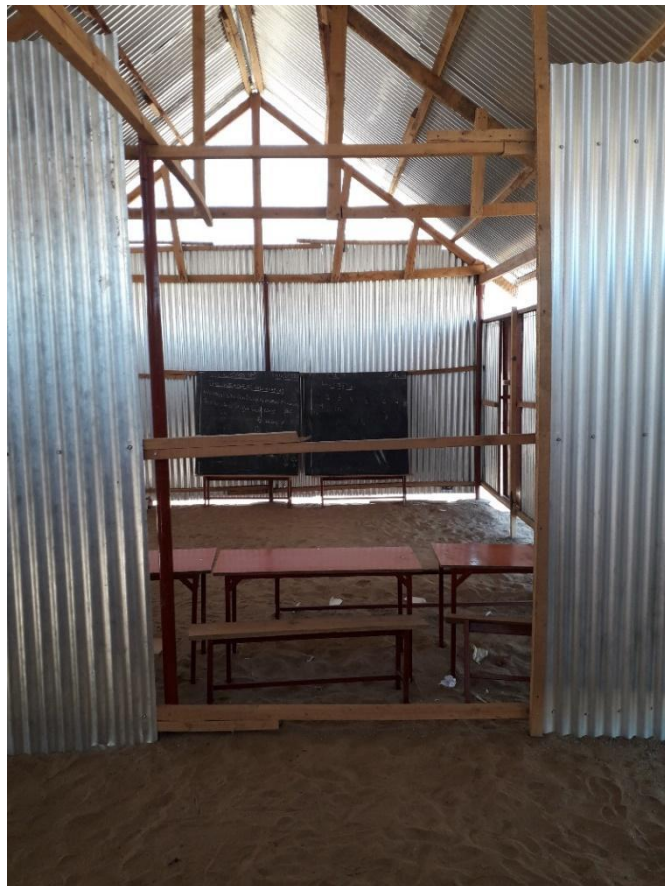
Hier fehlen drei Wellblechplatten, die zwei Klassen voneinander trennen sollten. Der Fußboden besteht aus Sand.
